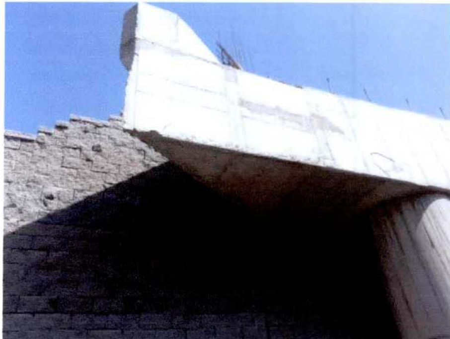
Fotografía N°2, Nidos de piedra en Vigas de salida del puente.
