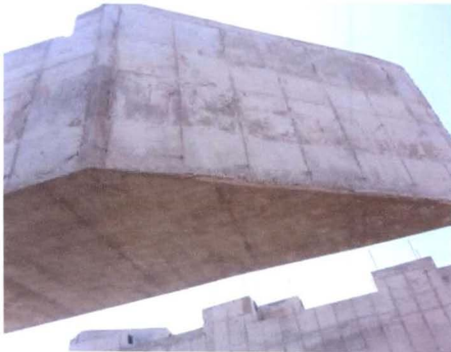
Fotografía N°3, Nidos de piedra en elemento estructural de cepa N°2
